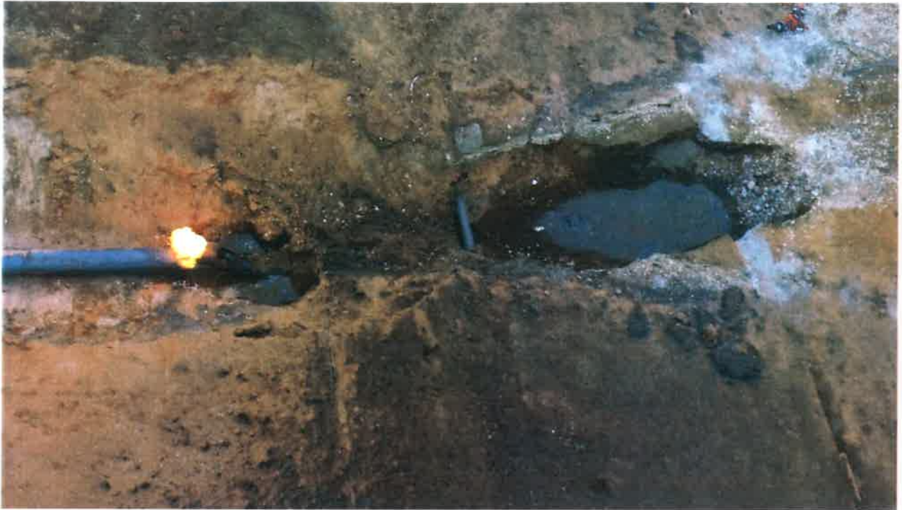
Rys. nr 9. Katastrofa budowlana gazociągu DN500 Poznań-Rogoźno, 26 stycznia 2018 r.
