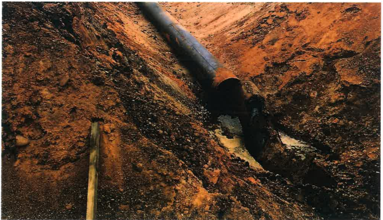
Rys. nr 10. Katastrofa budowlana gazociągu DN500 Poznań-Rogoźno, 26 stycznia 2018 r.
