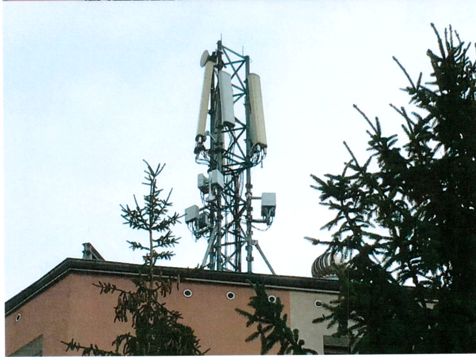
Nr 10 - ul. Warszawska 39/41 / Św. Michała stacja Plusa przed i po
